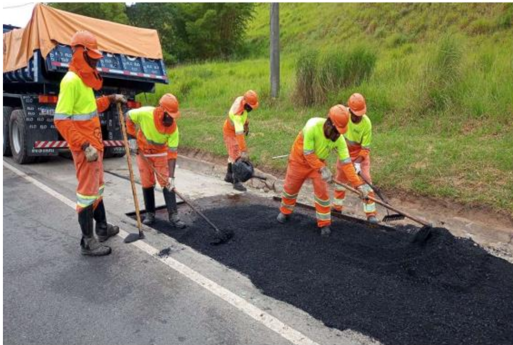
Figura 4.2 Via Lagos - Acostamento - Rep Superficial - KM 13+300 Norte
