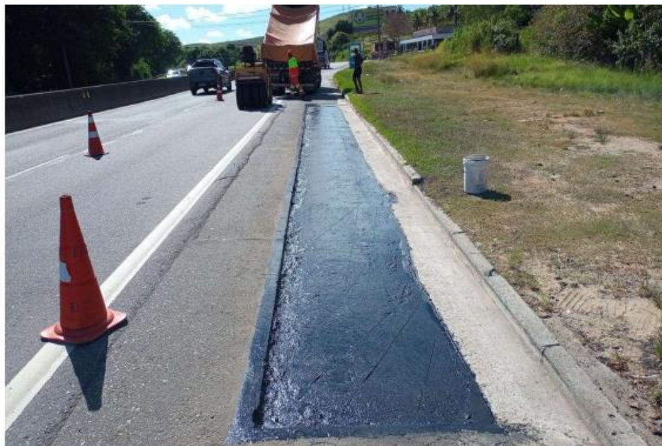
Figura 4.3 Via Lagos - Acostamento - Rep Superficial - KM 14+400 Norte
